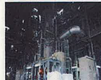
福島県県中浄化センター(郡山市)における下水汚泥焼却事業
