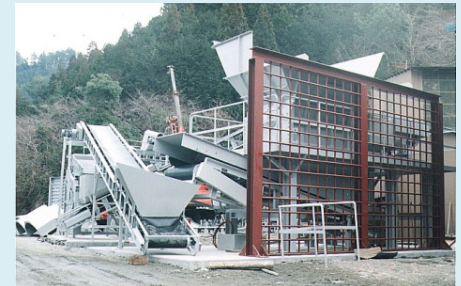
破砕切断施設
