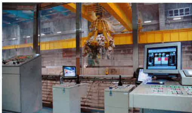
ごみクレーン操作室 ごみクレーンは、自動で投入・攪拌・積替を行います
