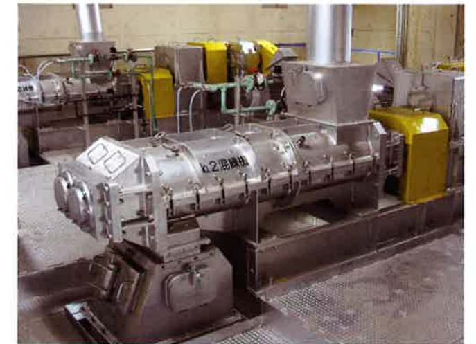
集じん灰薬剤処理装置 薬剤処理することにより、重金属類の溶出を防止します
