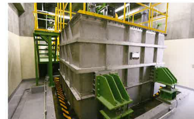
■脱水汚泥ホツパ
