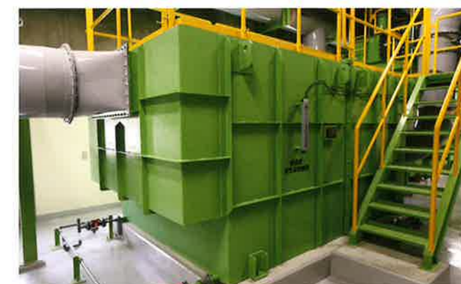
■低濃度活性炭脱臭塔
