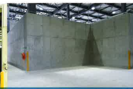
アルミ缶成型品貯留ヤード・スチール缶成型品貯留ヤード
