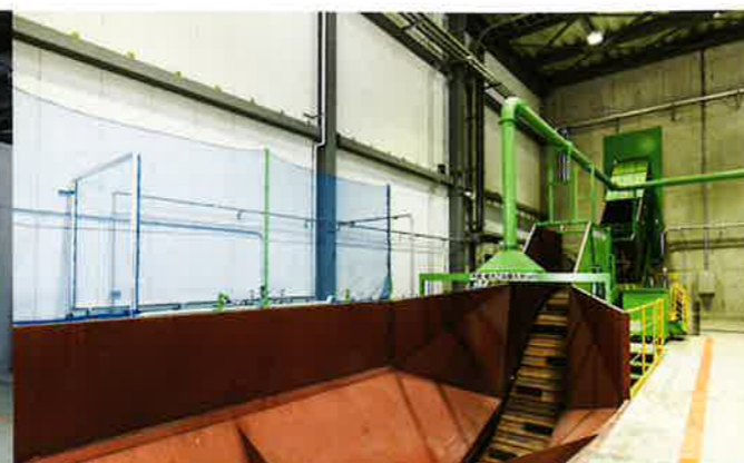
不燃ごみ・粗大ごみ供給コンベヤ
