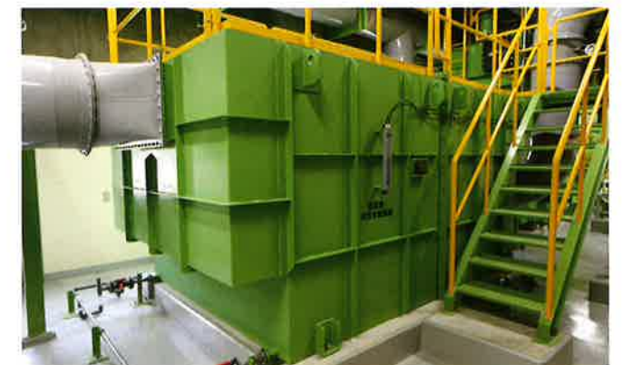
■低濃度活性炭脱臭塔
