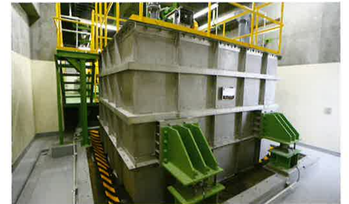
■脱水汚泥ホツパ
