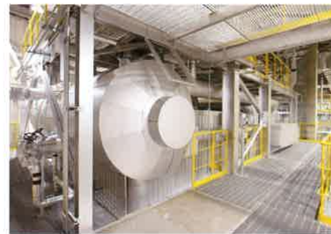
ボイラ 焼却炉から出た排ガスの熱を利用して蒸気をつくります。
