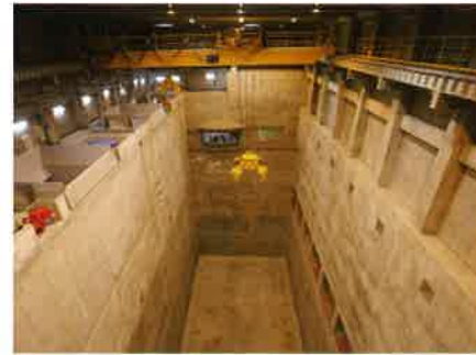
ごみクレーン・ごみピット ごみピットに貯められたごみは攪拌された後、ごみクレーンにてごみ投入ホッパへ投入します。
