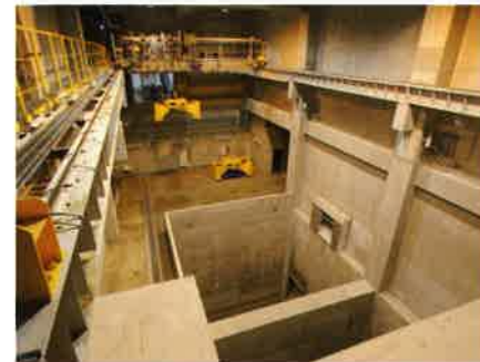
灰クレーン・灰ピット 灰は灰ピットに一時貯留され、場外に搬出されます。搬出された灰はエコセメントの原料として有効利用されます。
