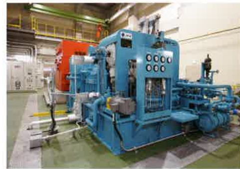
蒸気タービン発電機 ボイラで発生した蒸気を利用して、蒸気タービンを回し、最大9,700kWの電力を発生させます。
