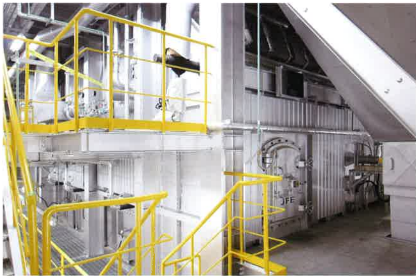
焼却炉 様々なごみ質に対応してそれぞれのごみ送り速度と燃焼用空気の吹き込み量を調節することで、850℃以上の高温で焼却を行い、ダイオキシン類の発生を抑制します。
