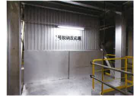
脱硝反応塔 アンモニアを噴霧して触媒の層を通過させ、排ガス中の窒素酸化物を分解します。
