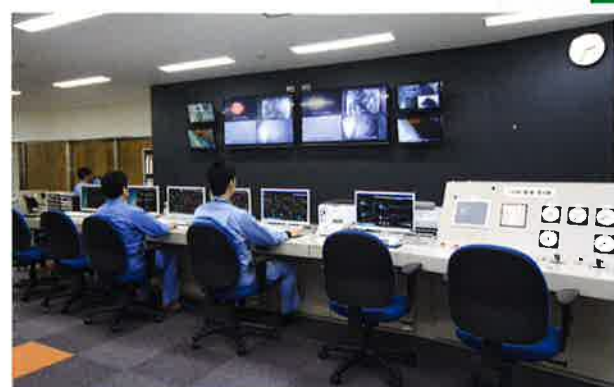
中央制御室 熱回収施設内の機器と設備全体の監視・制御や運転操作をここで集中して行っています。
