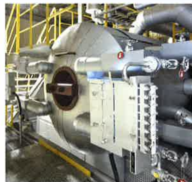
ボイラ 排ガスの熱を利用して、ボイラで蒸気を作ります。
