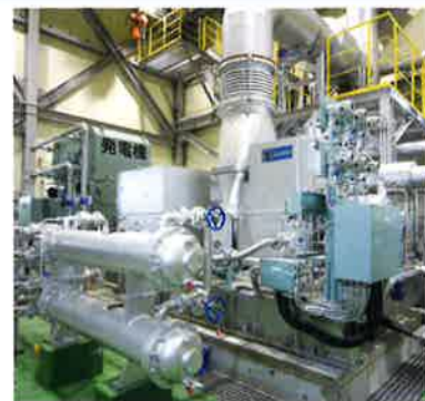
蒸気タービン発電機 ボイラで発生した蒸気を利用して、最大1900kWの発電をしています。
