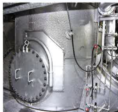
ガス化炉 供給されたごみは500~600℃の流動する砂と混合し、ガス化炉で熱分解した後、溶融炉へ送られます。
