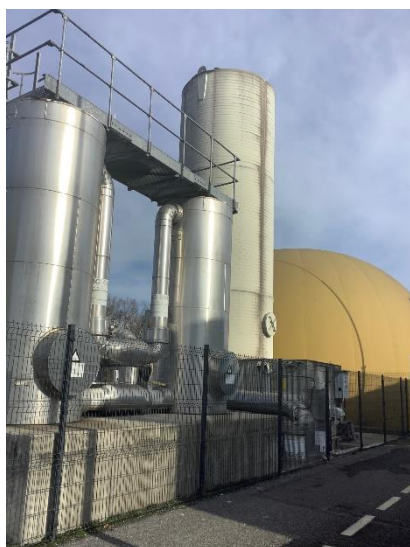
脱硫装置(左)、ガスタンク(右)外観
