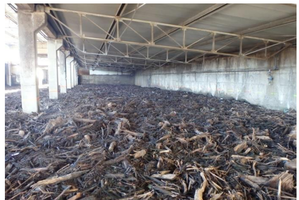
図 14. バイオフィルター (脱臭施設)
