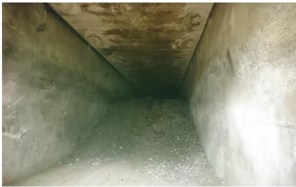
図 11. バイオトンネル (内部)
