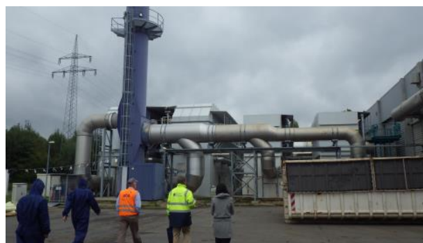
臭気処理装置（酸洗浄、RTO 脱臭）
