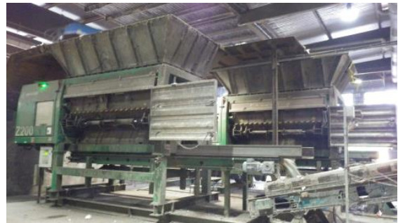
MBT 施設 現場視察 (破碎機外観)
