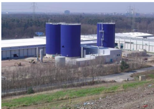
メタン発酵槽外観
