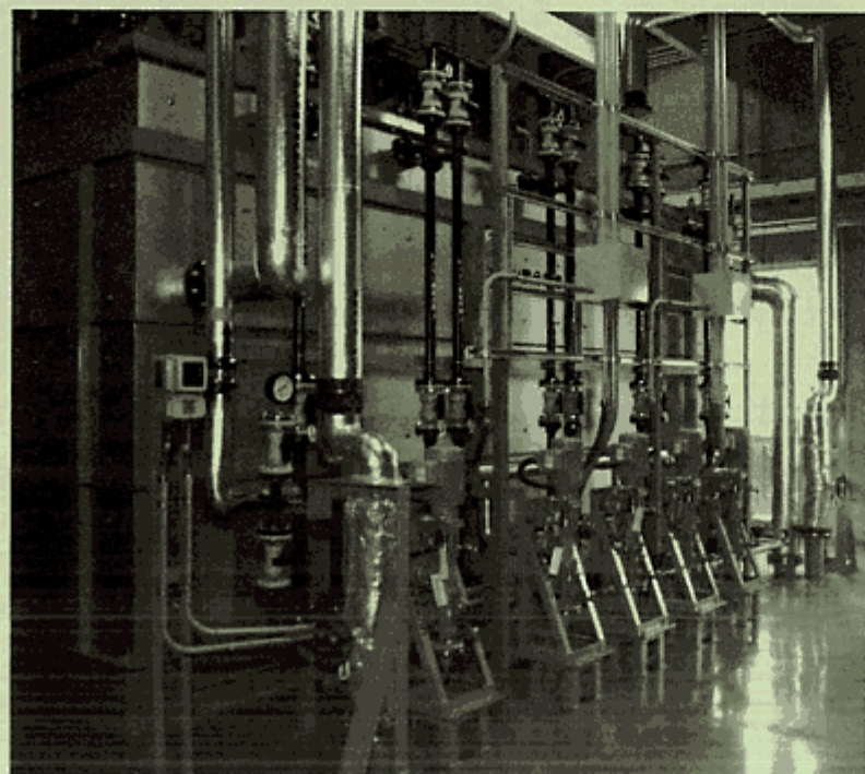
メタン発酵槽(地下)とメタン膜分離槽
